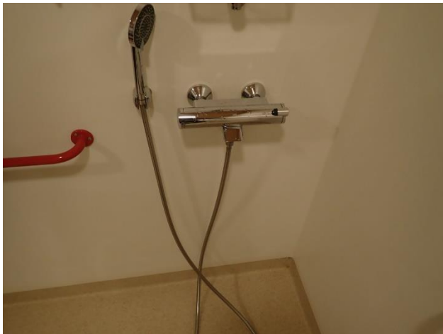
Yleiskuvia vesi- ja viemärikalusteista, ja putkiasennuksista.
