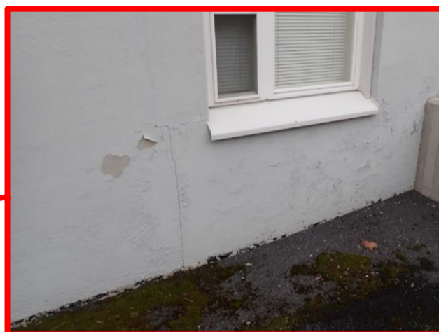
Maalipinnassa on havaittavissa runsaasti maalipinnan hilseilyä.
