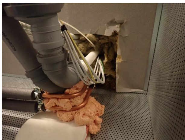
Kompressorihuoneen läpiviennit eivät havaintojen perusteella täytä palokatkomääräyksiä.
