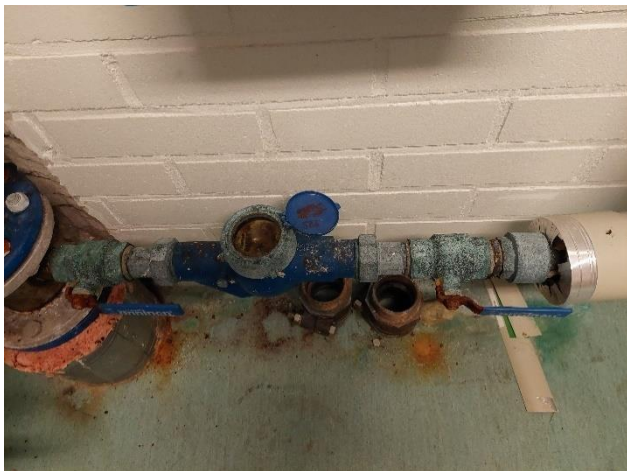
Sprinklerikeskuksessa sijaitsevassa vesimittarissa ja sulkuventtiileissä korroosioauriota.
