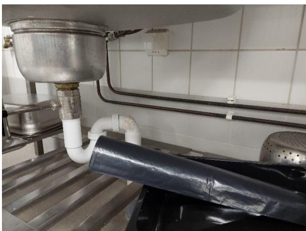
Yleiskuvia vesi- ja viemärikalusteista ja putkiasennuksista
