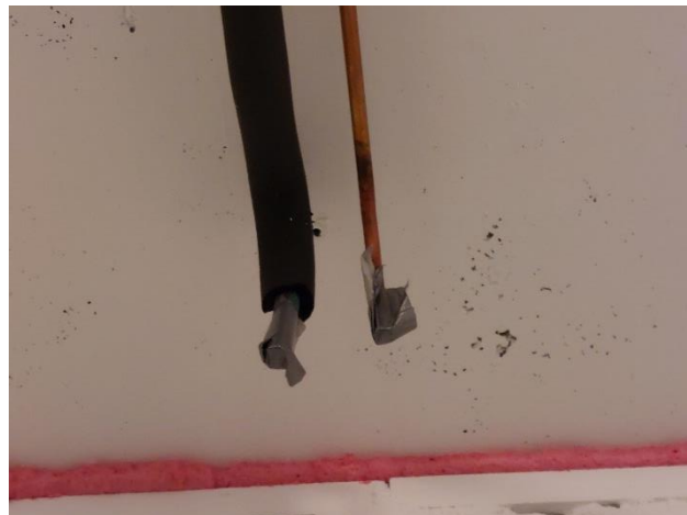
Puutteellinen tulppaus tilassa 0.031
