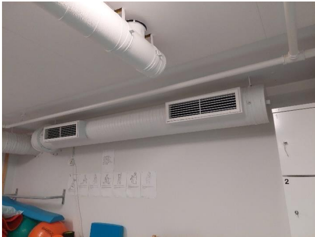
Yleiskuva ilmanvaihtokanavista ja päätelaitteista VSS-tiloissa
