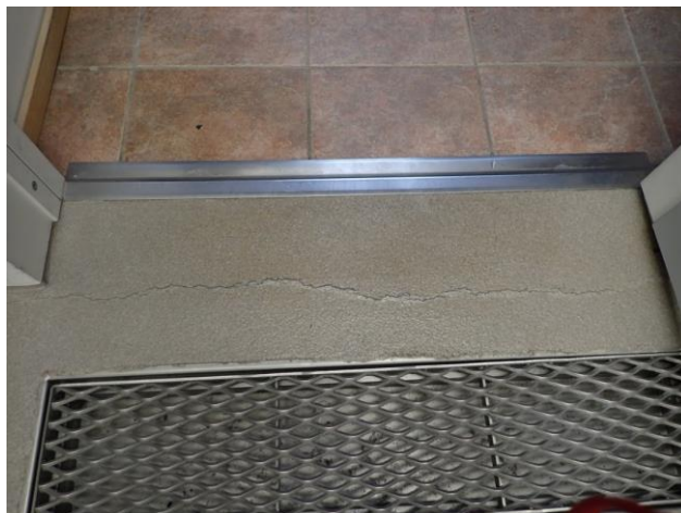
Keittiön akryylibetonilattiassa havaittiin paikallinen vaurio, jonka huoltokunnostus on suositeltavaa.
