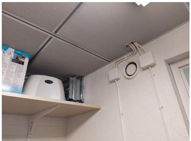
Heikosti toimiva ilmanvaihto varastotilassa 0.014.
