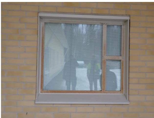
MEK-tyypin metalli-ikkuna on ruostunut.
