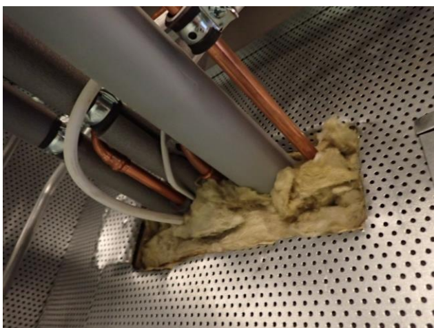
Kompressorihuoneen läpiviennit eivät havaintojen perusteella täytä palokatkomääräyksiä.
