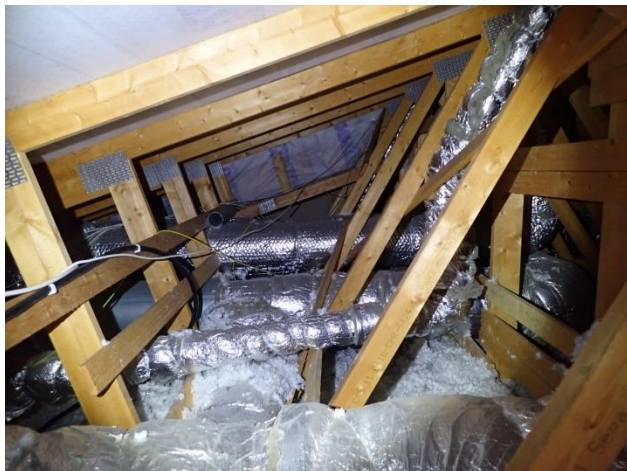
Yleiskuva IV-kanavistojen asennuksista yläpohjassa.
