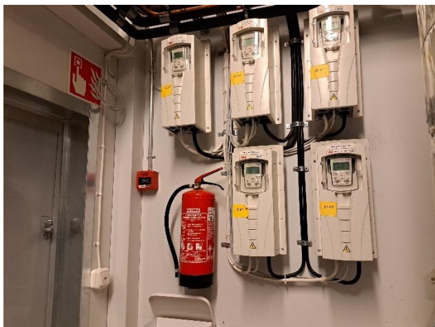
Pääkeskustilassa sijaitseva taajuusmuuttaja ilman potentiaalintasausta.
