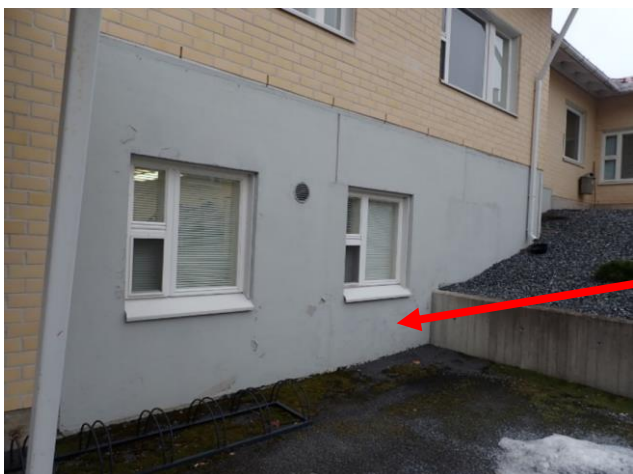
Paikallisesti betonirakenteiseen ulkoseinään kohdistuu kosteusrasitusta.
