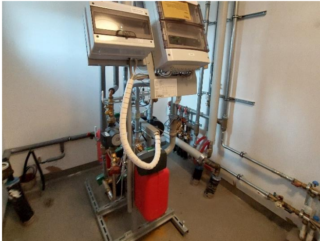
Yleiskuvat lämmön alajakokeskuksesta.
