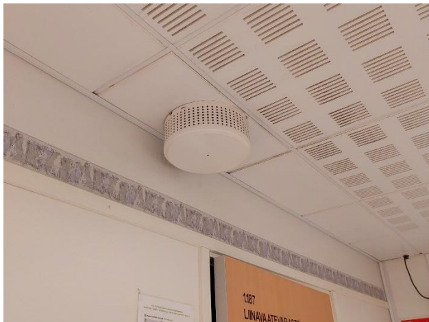
Yleiskuvat tuloilman päätelaitteista.
