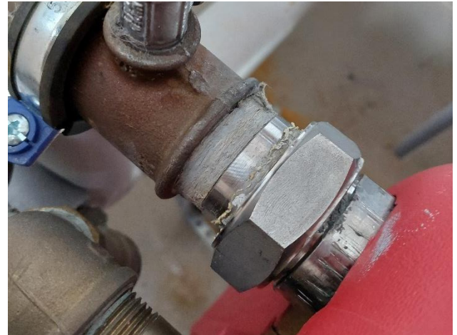
Putkiliitoksessa aktiivinen vuoto
