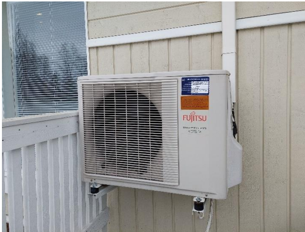
Yleiskuvat ilmalämpöpumpusta ja sen sisäyksiköstä.
