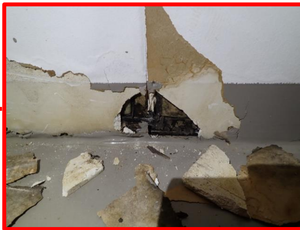
Seinärakenteen alaohjauspuu on tummunut.
