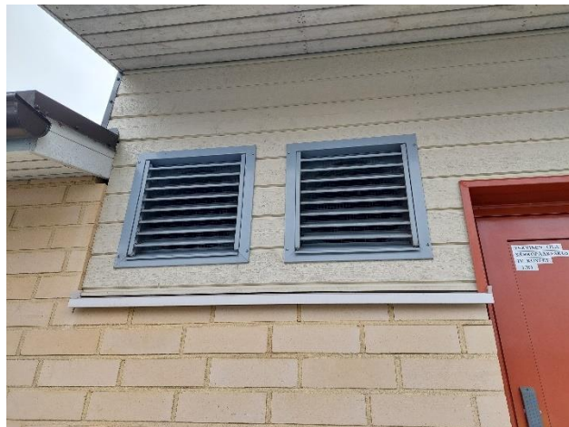
Yleiskuva IV-konehuoneen ulkoilmasäleiköistä.
