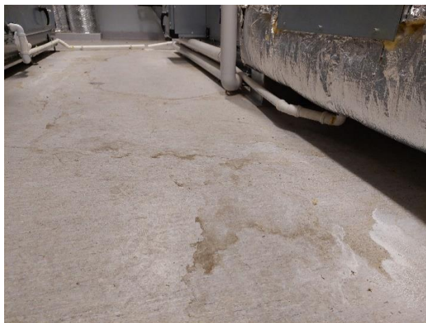
Yleiskuva ilmanvaihtokoneen lattiasta, jossa vanhoja vuotojälkiä.
